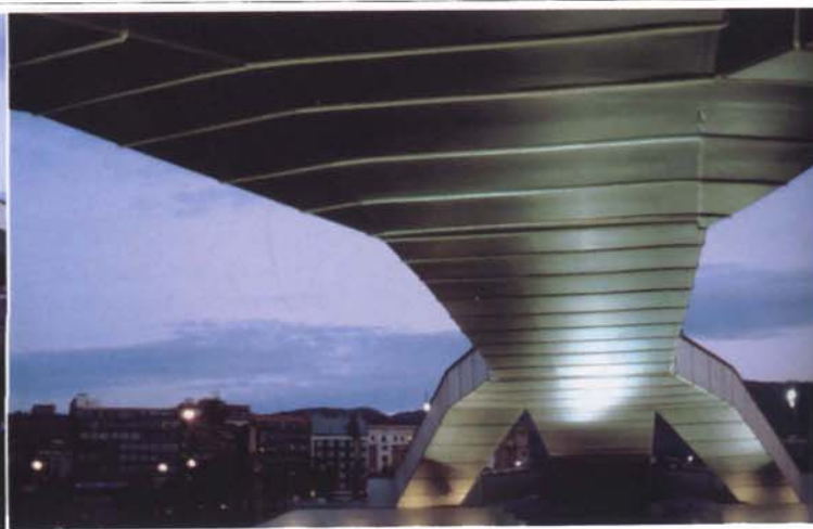
Fig. 112. Puente de Abandoibarra. A. Aguirre, I. Garmendia y I. Izquierdo. Estudio: Estudio Guadiana.
